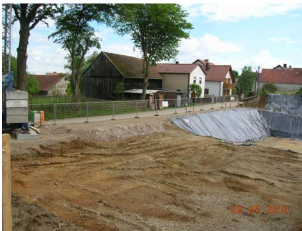
Blick nach Nordosten im Vordergrund: nicht unterkellertes Bereich im Hintergrund: unterkellertes Bereich
